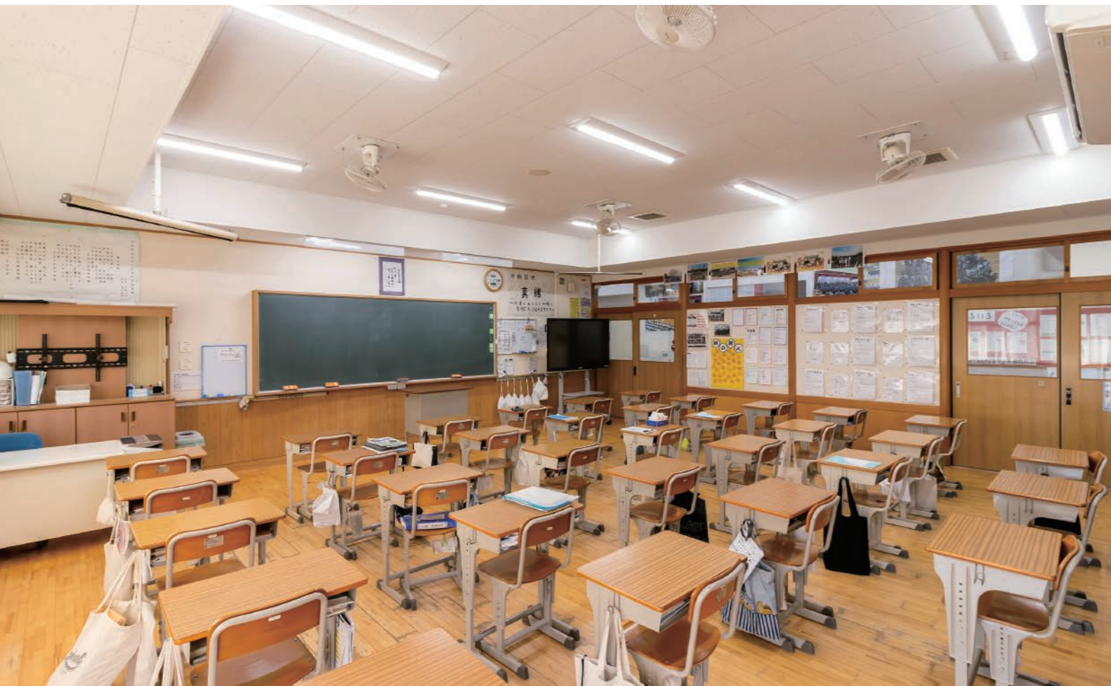
ちはら台西中学校 普通教室の照明 天井照明は直付タイプのLEDベースライト①に更新。黒板灯②もLED化。
