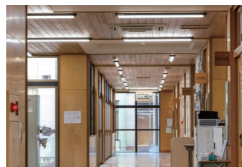
廊下 LEDベースライト③による照明。
