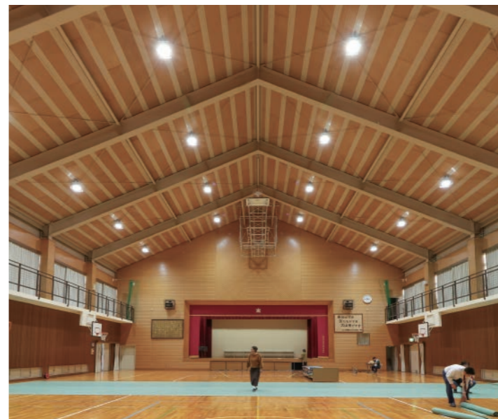
体育館 LED高天井器具④による照明。
