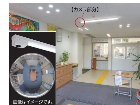
職員用玄関の照明 カメラ付きLED照明ViewLED⑦を新たに導入。
